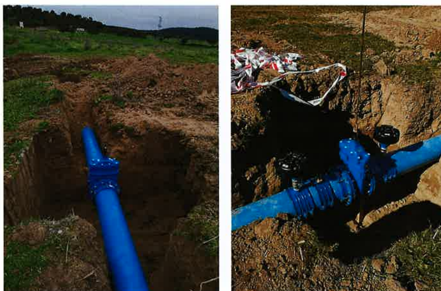
Fig. 7-Tubería en zona exterior
