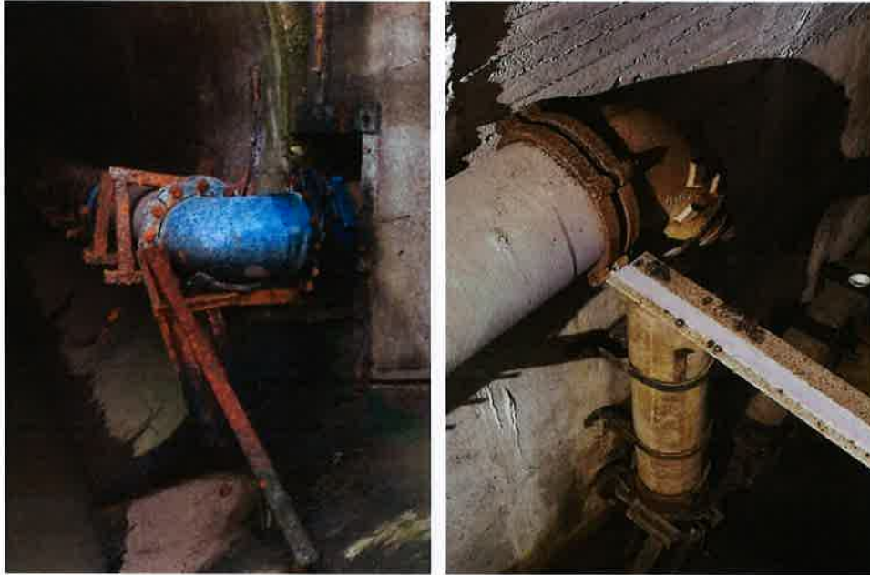
Fig. 5-Fotografías donde se aprecian los refuerzos existentes en los codos antes de las obras del 2020, la fotografía de la izquierda era el codo a la salida del túnel y la fotografía de la derecha era el tramo inicial de la tubería en la pasarela superior.
