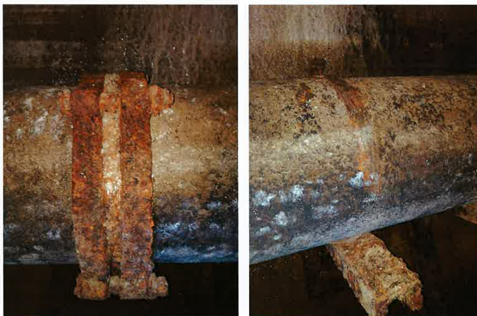
Fig. 2- Estado de la tubería de fibrocemento, uniones y anclajes.
