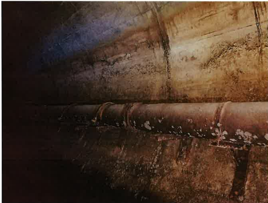
Fig. 10-Detalle tubería, pletinas, y soportes en el túnel
